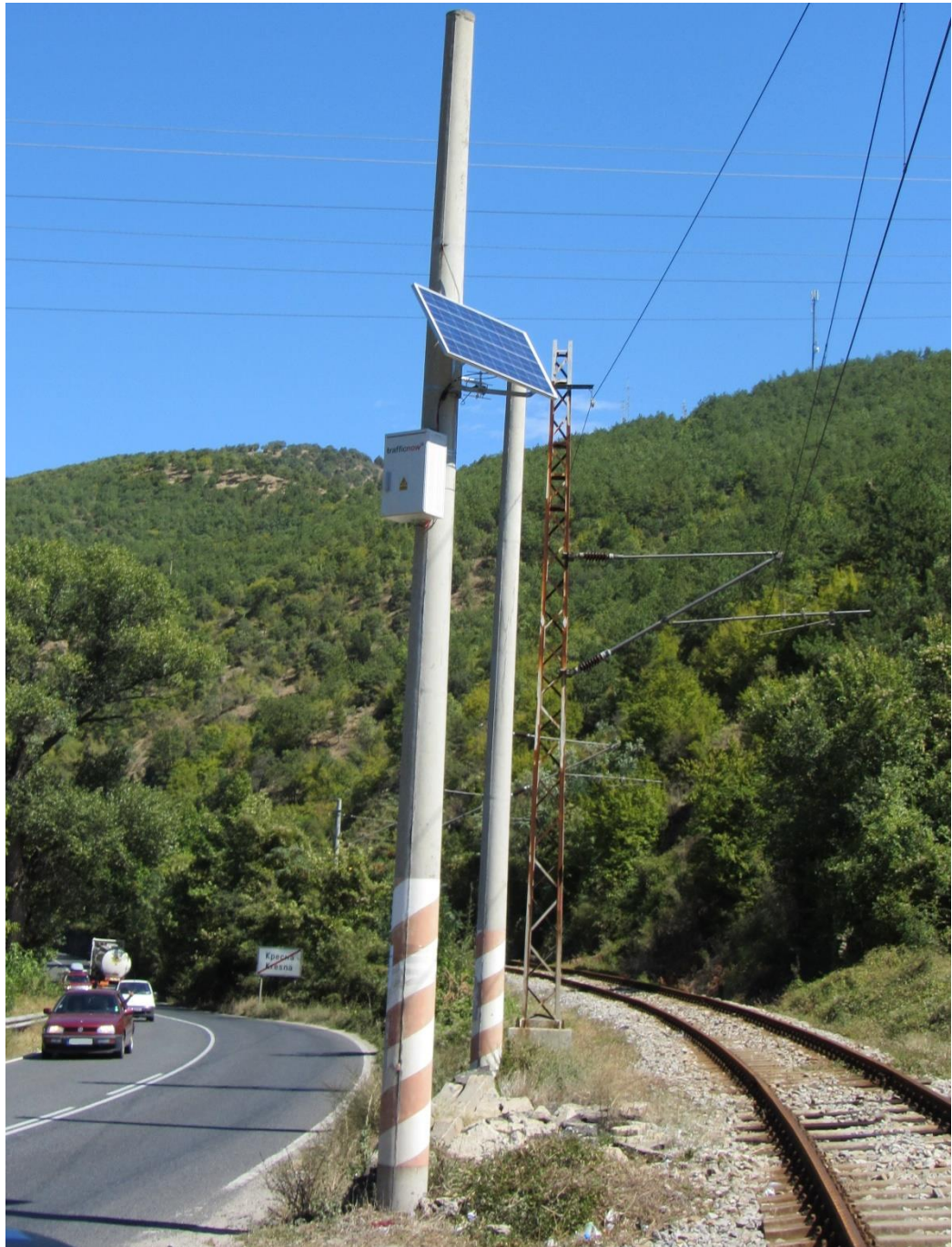
На снимката са показани метална кутия и соларен панел, монтирани в северния край на гр. Кресна.
